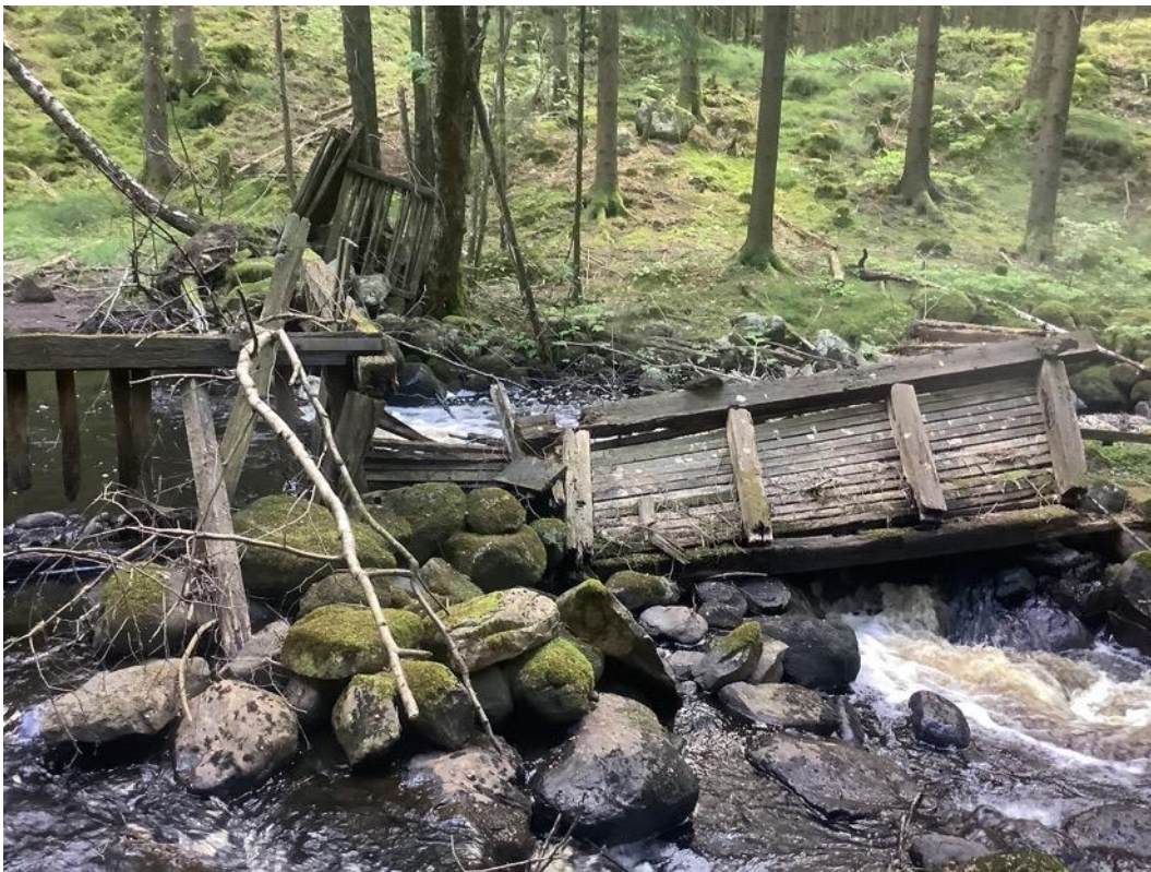
Figur 59. Raserad kvarndamm och ålkista som bedöms utgöra ett partiellt hinder för både starksimmande och svagsimmande arter.
