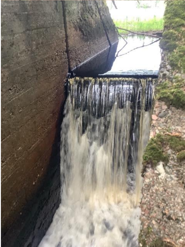
Figur 66. Betongkonstruktion (övre bild) och skibord (nedre bild) vid den övre av Pugabols dammar. Dämnet bedöms vara ett definitivt vandringshinder.
