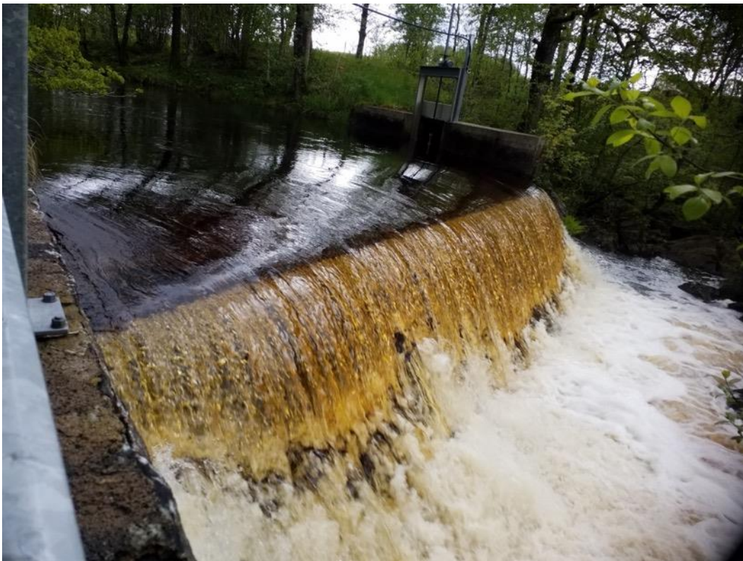
Figur 32. Dammvallen vid Sembs mölla där en betongdamm byggts på högst upp på den naturliga forsén. Dammvallen bedöms vara ett definitivt vandringshinder för fisk.
